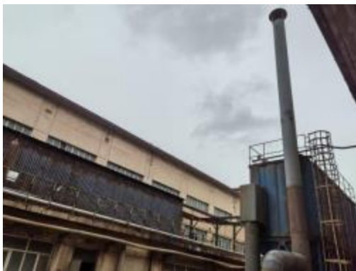
一车间除尘器及排气筒
