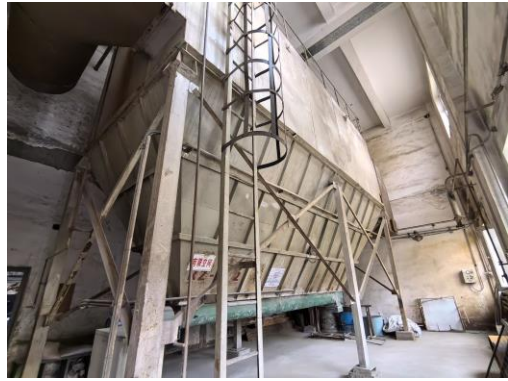
三车间除尘器
