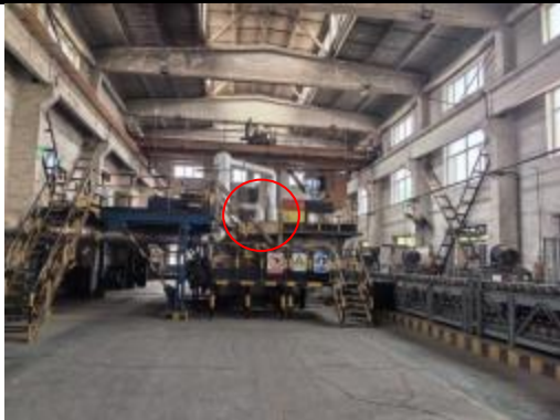
一车间 1#600KW电炉（拟建 2100KW电炉）
