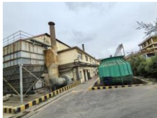
三车间除尘器及排气筒
