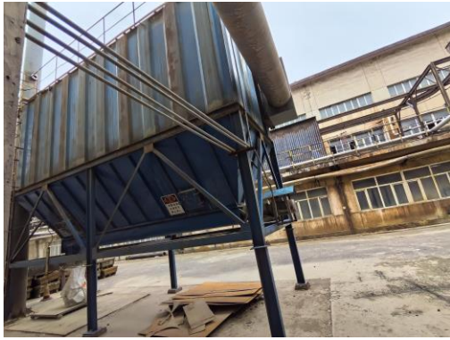
一车间除尘器
