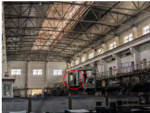
三车间 1#600KW电炉、2#600KW电炉
